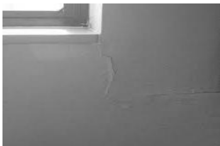
Рисунок 2. Мелкие трещины в стене
