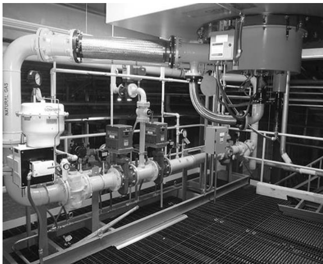
Рисунок 3. Горелочное устройство реконструируемого котла
