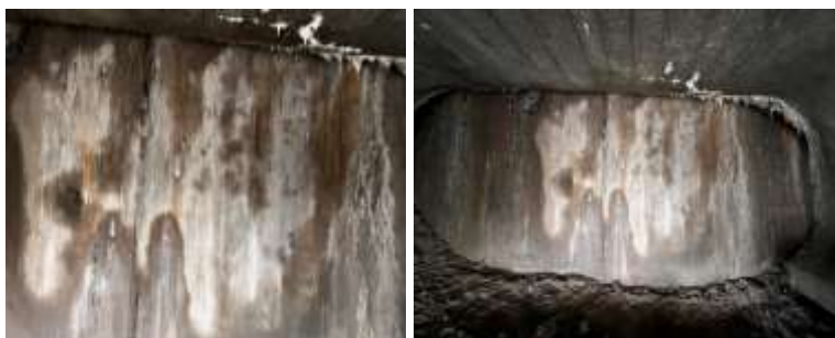
Рисунок 4. Следы протечки воды и выщелачивание бетона в месте устройства деформационного шва
