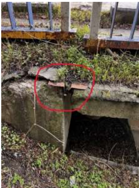
Рисунок 3. Сплошная коррозия конструкции деформационного шва
