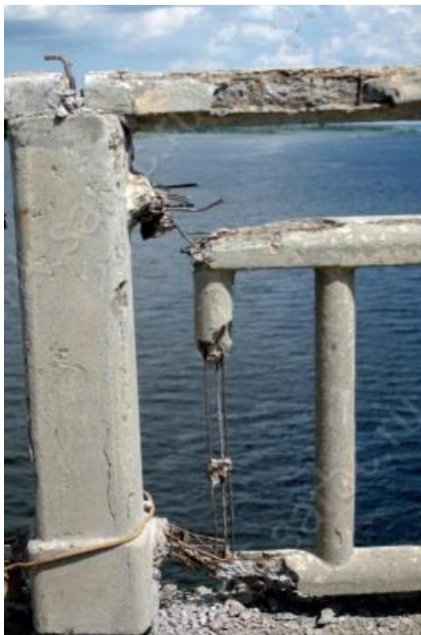
Рисунок 3. Разрушение конструкции перильного ограждения моста [1]
