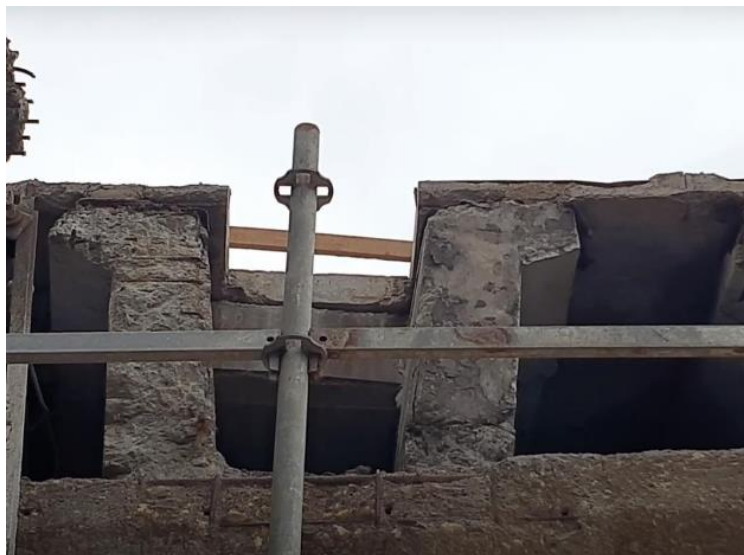
Рисунок 3. Разрушение защитного слоя и коррозия арматуры балок путепровода [2]
