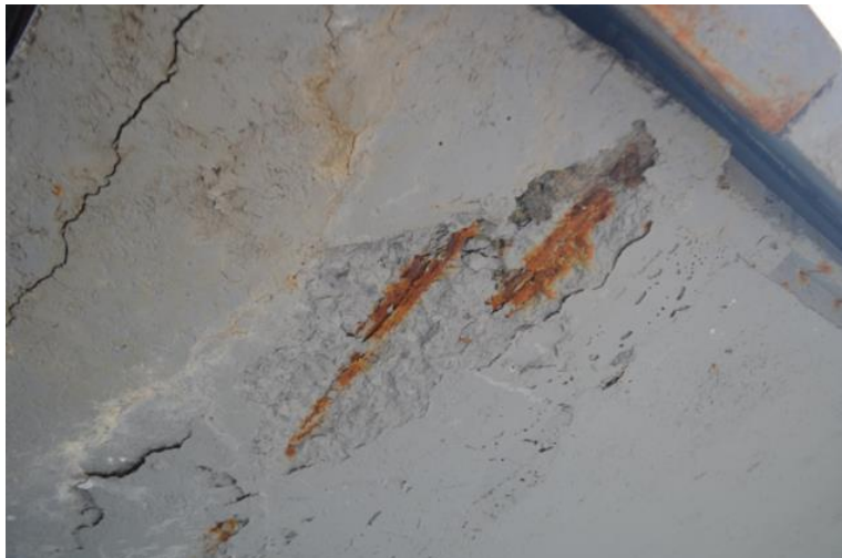
Рисунок 1. Разрушение защитного слоя и коррозия арматуры плиты сталежелезобетонного пролетного строения моста [3]
