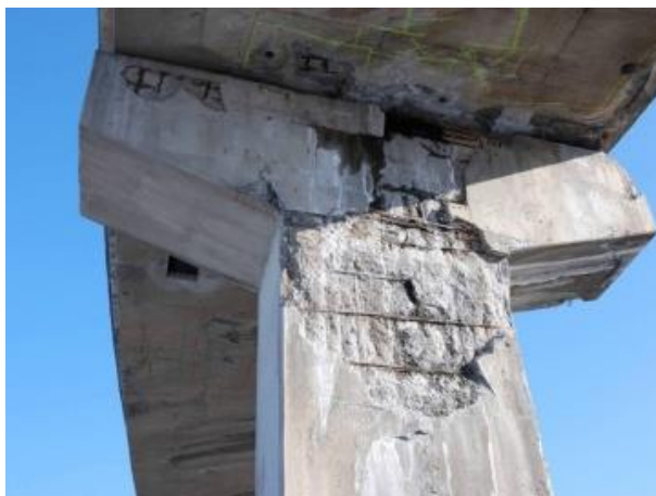
Рисунок 4. Разрушение защитного слоя и коррозия арматуры ригеля и тела опоры моста [7]
