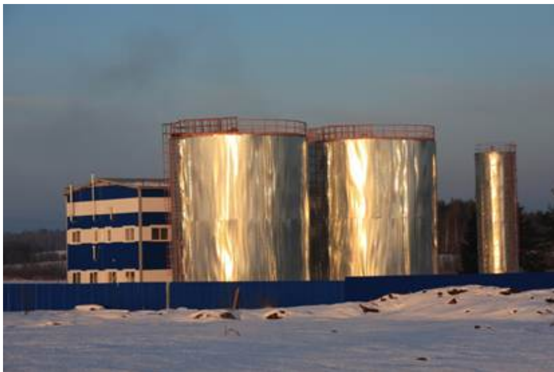
Рисунок 1. Очистные сооружения ООО «Водоканал» города Кириллов
