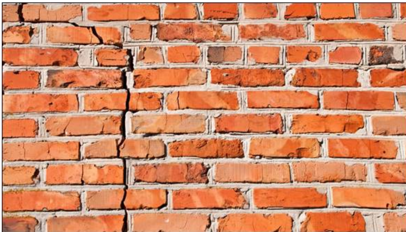
Рисунок. 4. Вертикальные щели в каменной кладке
